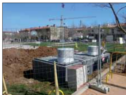
Transformador a la Plaça Figueres 14 d'abril 2009
