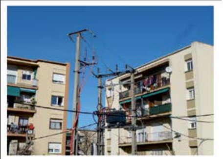
8) Eliminar el transformador aeri del c. Ullastret.
